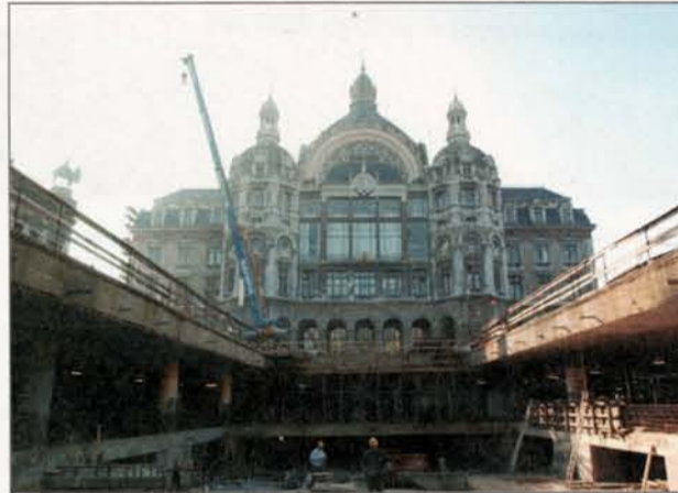
Onder het Astridplein wordt er volop gewerkt aan de parking en de ondergrondse niveaus.
